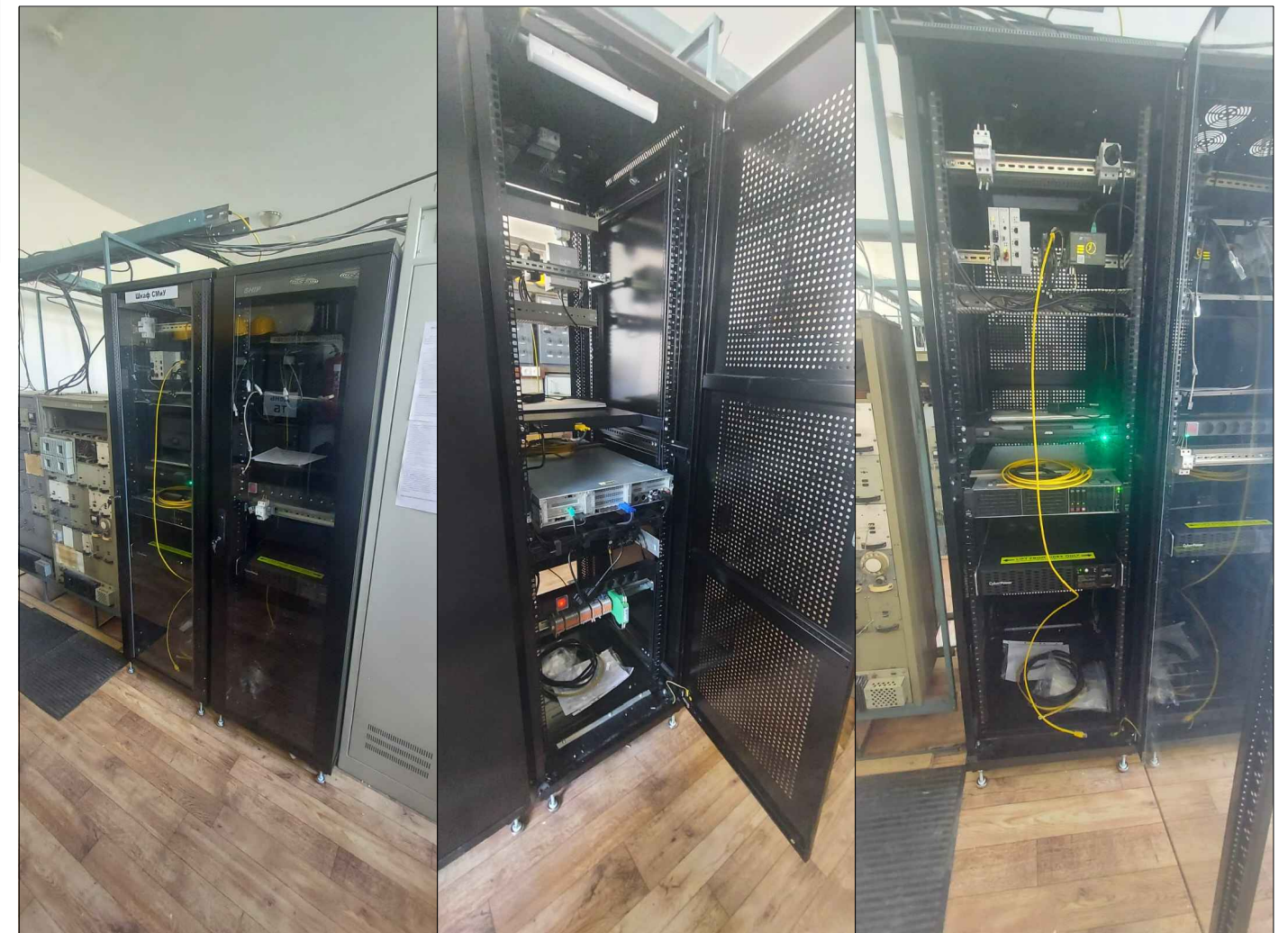
ОБОРУДОВАНИЕ УСТАНОВЛЕННАЯ НА ТЕРРИТОРИИ ЦЕНТРАЛЬНОЙ ДИСПЕТЧЕРСКОЙ АО "ТАТЭК"----
