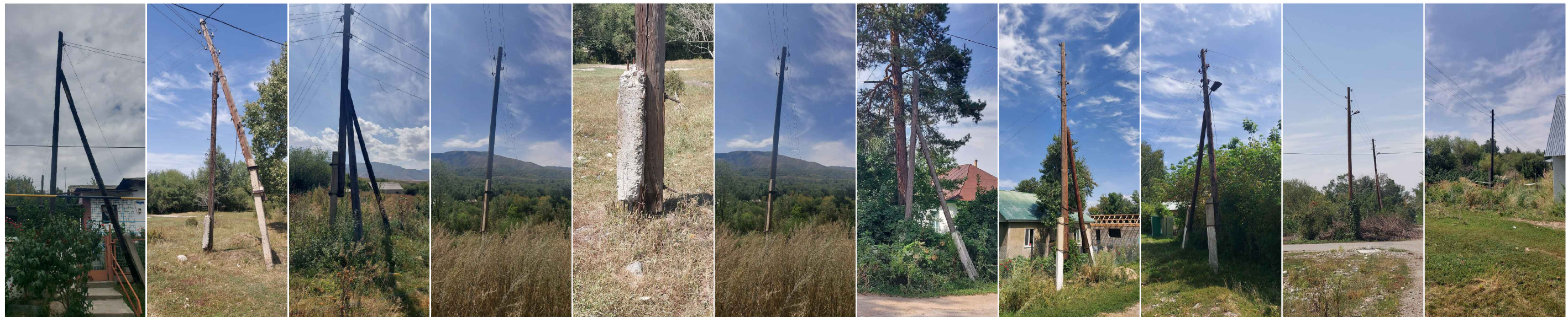
Существующая линия ВЛ-6/0,4кВ №6301 от ПС-163 выполнена на деревянных стойках с подвеской неизолированного провода.
